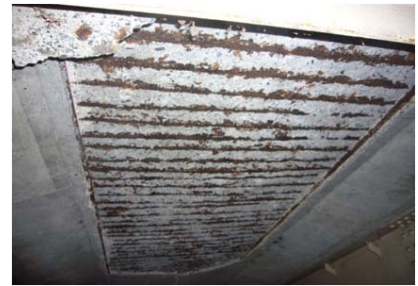
写真-1 床版下面コンクリートはく落
