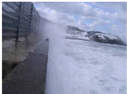
写真-2 波浪時の海岸護岸壁状況
