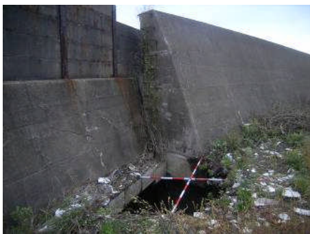
写真-1 陥没発生状況
