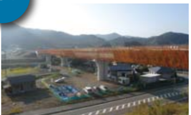
都市計画道路日知屋一財光寺通線や県道土々呂日向線が開通。東九州自動車道門川IC一日向IC間の工事も順調に進む。写真は、塩見地区。
