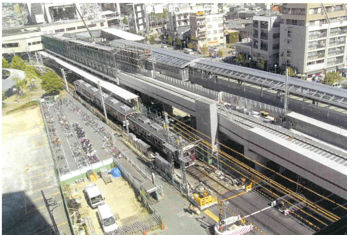
供用開始に向けて高架化工事中の西宮北口駅・今津ゆき新ホーム(地上部分は現在のホーム) 2010年10月撮影
