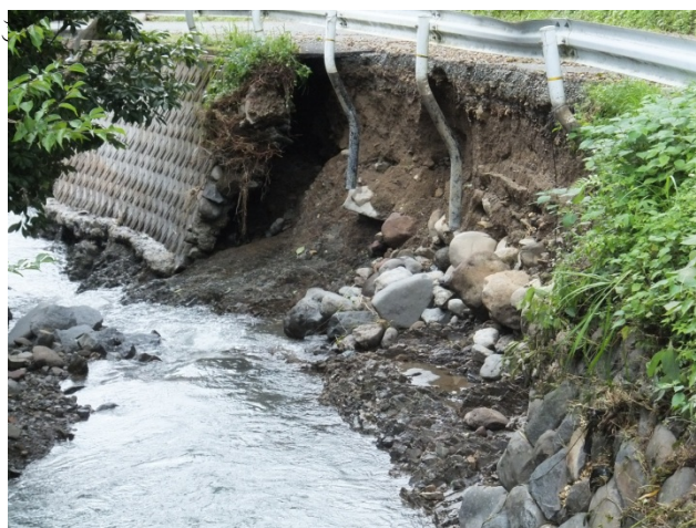
図 6.14 河床低下により露出した護岸の根入れ部分および、護岸浸食の様子。写真の箇所の下流部分には被災前に堰が存在した。
