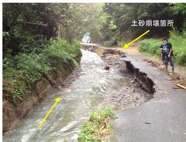
図 6.9 土砂崩壊との複合災害と思われる箇所（小河内川）
