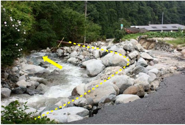
図 6.11 乙石川の被災状況 (点線は被災前の護岸法肩法線)
