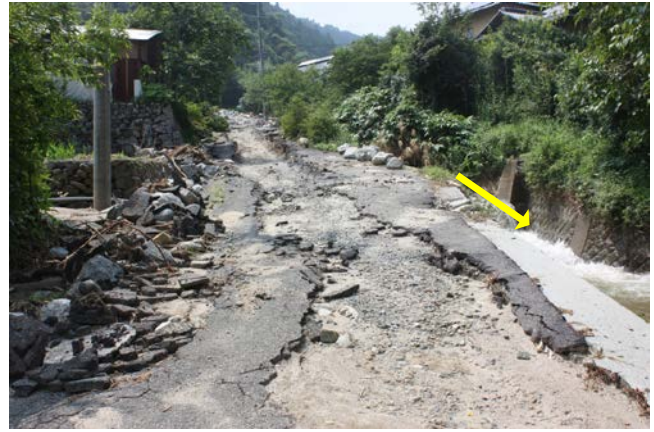
図 6.12 乙石川の被災状況 (河道横の道路上を洪水流が流下した痕跡)
