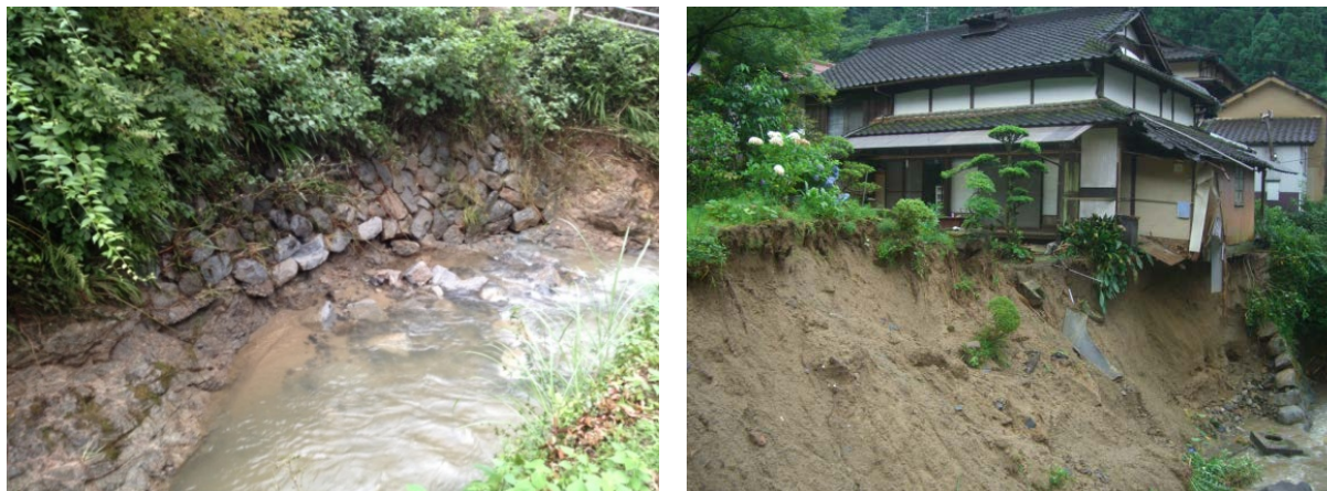
図 6.16 石積み護岸の被災例 左：石積み護岸が段階的に崩壊している様子，右：護岸全体が流失した被災箇所
