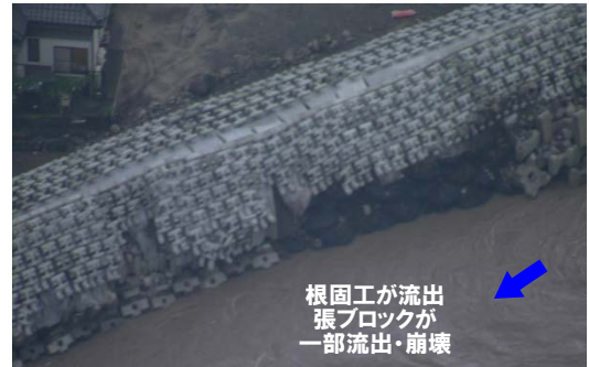
写真6.6* 応急復旧箇所の被災状況 (拡大)
