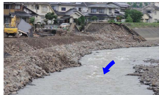
写真6.2 決壊区間 6.1k付近より上流
