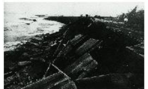
崩壊した海岸堤防(富士海岸富士地区)
