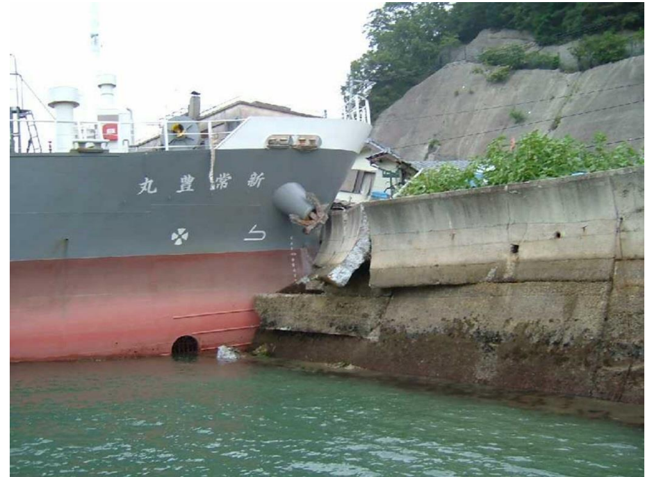
船舶が海岸保全施設を破壊した例(平成16年広島県大崎上島町)
