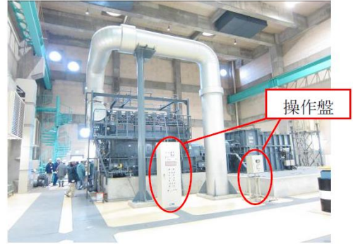
操作盤の高さの確認
