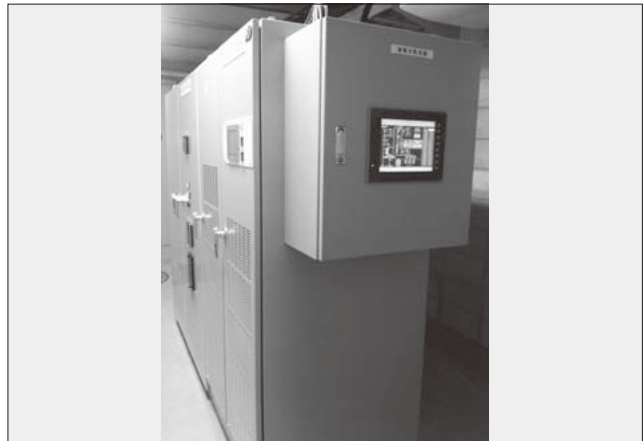
図 29 交直変換装置と監視制御盤
