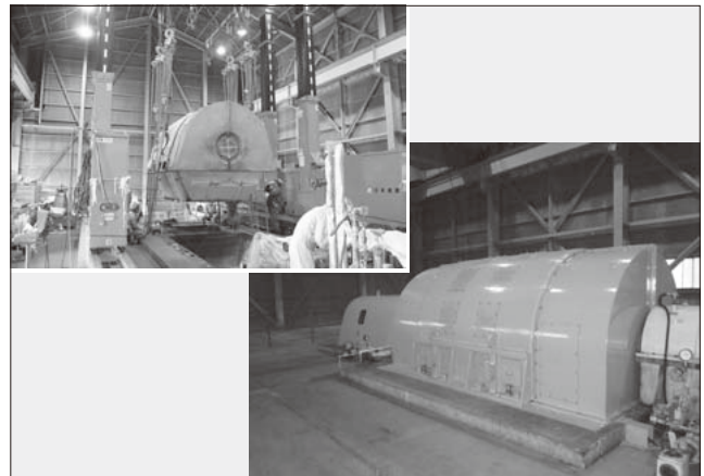
図42 旧発電機固定子の搬出状況と新発電機固定子の設置状況
