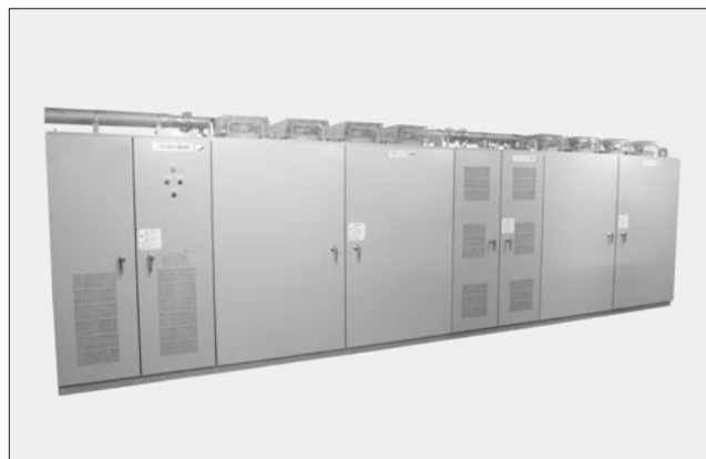
図27 独立行政法人 鉄道建設・運輸施設整備支援機構電力補償装置
