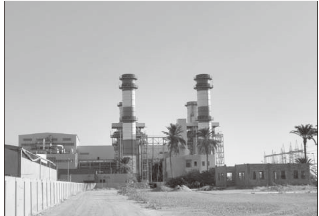
図 52 リビア電力庁ベンガジ発電所
