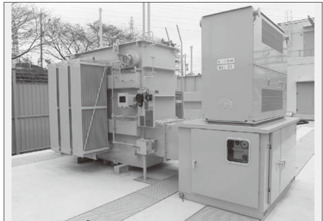
図 28 66 kV 受電直流変電設備
