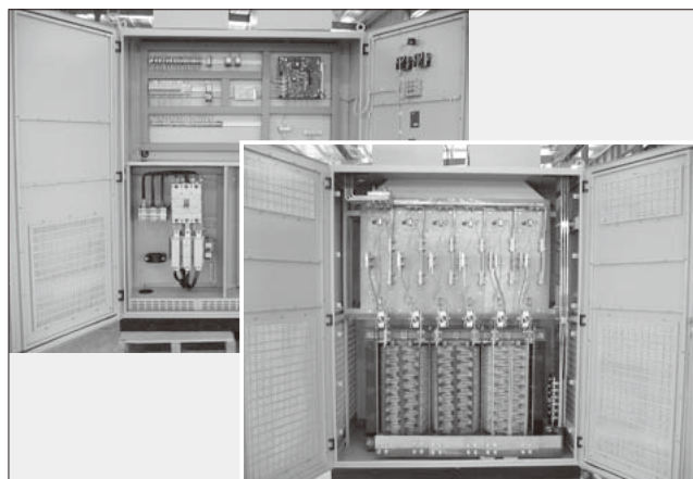
図 32 電気めっき設備用整流器
