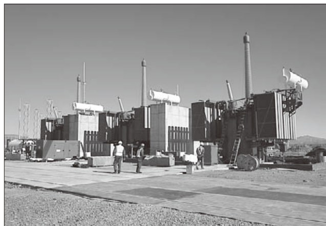
図26 765 kV 400 Mvar分路リアクトル
