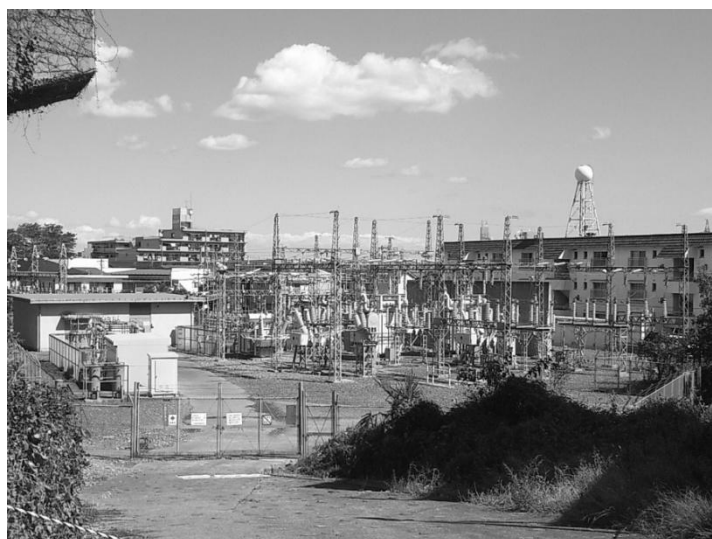
図1：東仙台変電所
