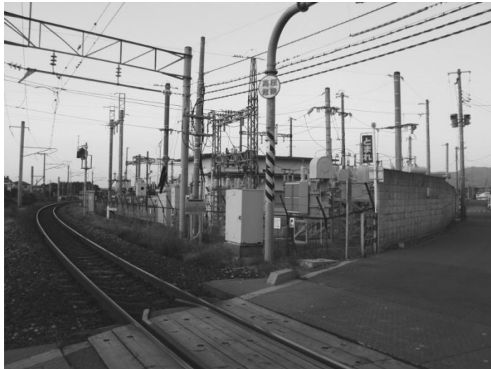
図2：羽前千歳変電所
