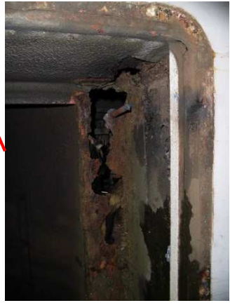
■ ラジエータ水室取付枠腐食
