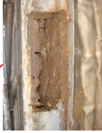
■ サン板取付部腐食
