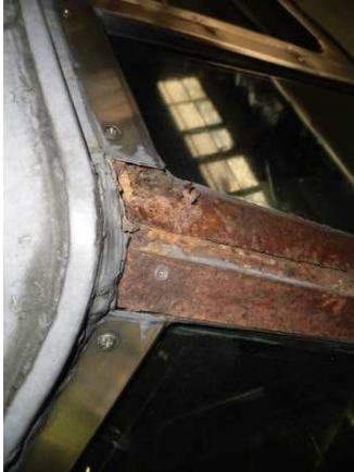
■ 運転台ガラス枠腐食
