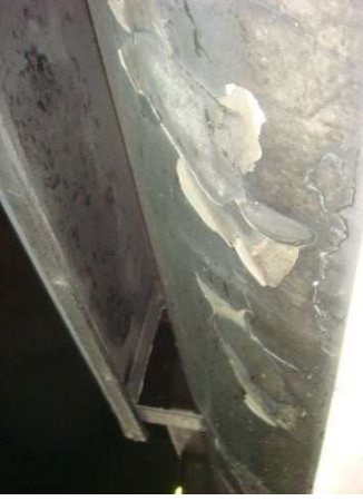
■ 屋根塗装剥離
