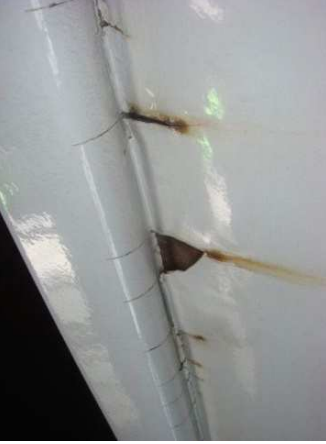
■ 雨樋取付部腐食及び塗装剥離
