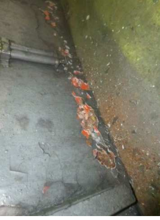
■ 屋根上機器腐食
