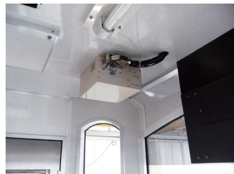
■ 運転状況記録装置のぎ装状態の例
