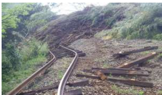
写真 激しい軌道変状
