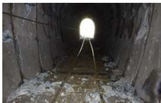
写真 犀角山トンネル内の亀裂
