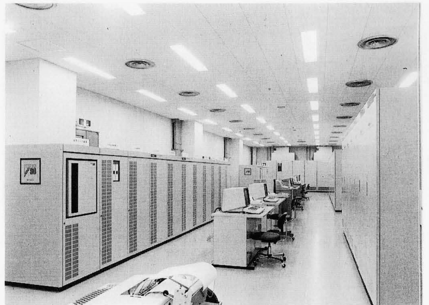
図4 総合指令センタシステム機器室 手前が設備管理の機器、奥が運行管理の機器である。
