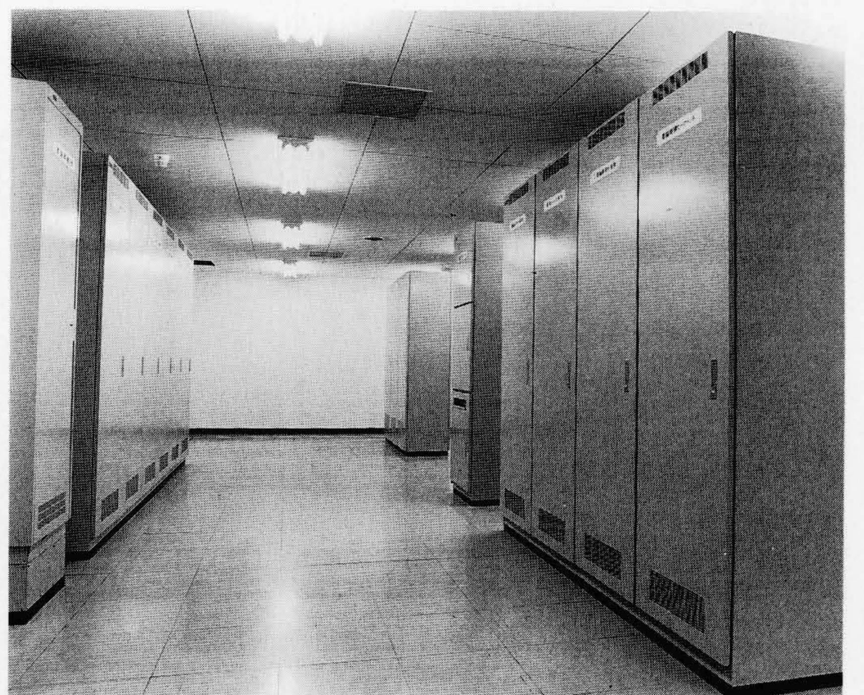
図6 駅のシステム機器室 運行管理システムと設備管理システムの駅制御装置が、同一フロアに設置されている。
