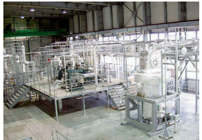
30kW 海洋温度差発電装置
