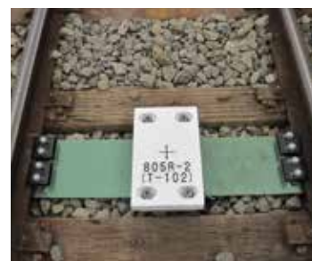
連続速度照査用のATS地上子
