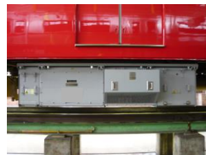
3500系補助電源装置
