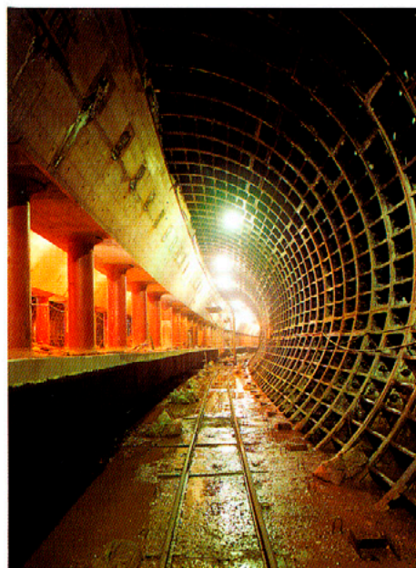
宮団地下鉄有楽町線永田駅のGコラム
