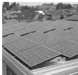
図 4.14 太陽光発電パネル
