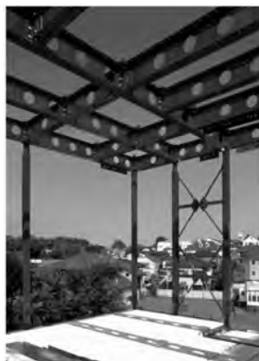
図 2.27 ハイパーフレーム構造 （旭化成ホームズ）（旭化成ホームズ提供）
