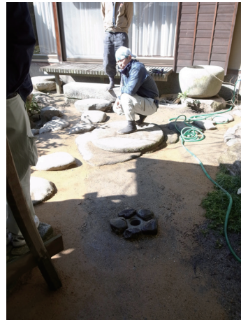
写真23 浸透枡（画面中央の下側）
