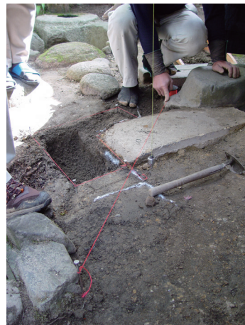
写真34 雨落の位置の確認状況 (写真中央の黄色い糸と重りが雨落ちの位置を示す)
