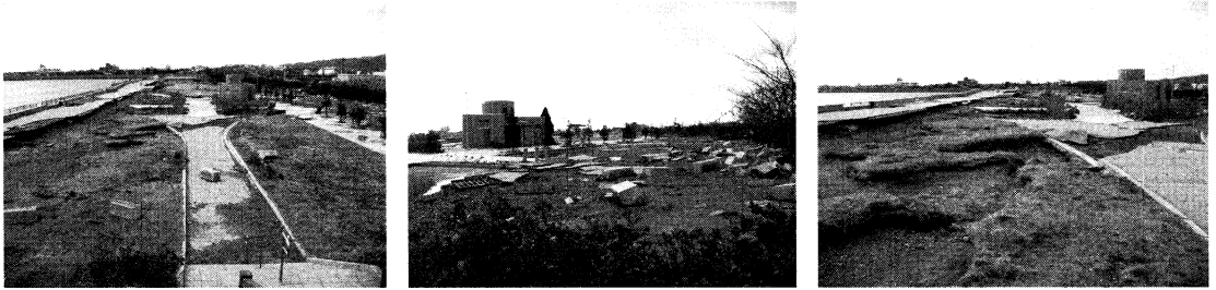
写真-3 万葉埠頭緑地の被災状況
