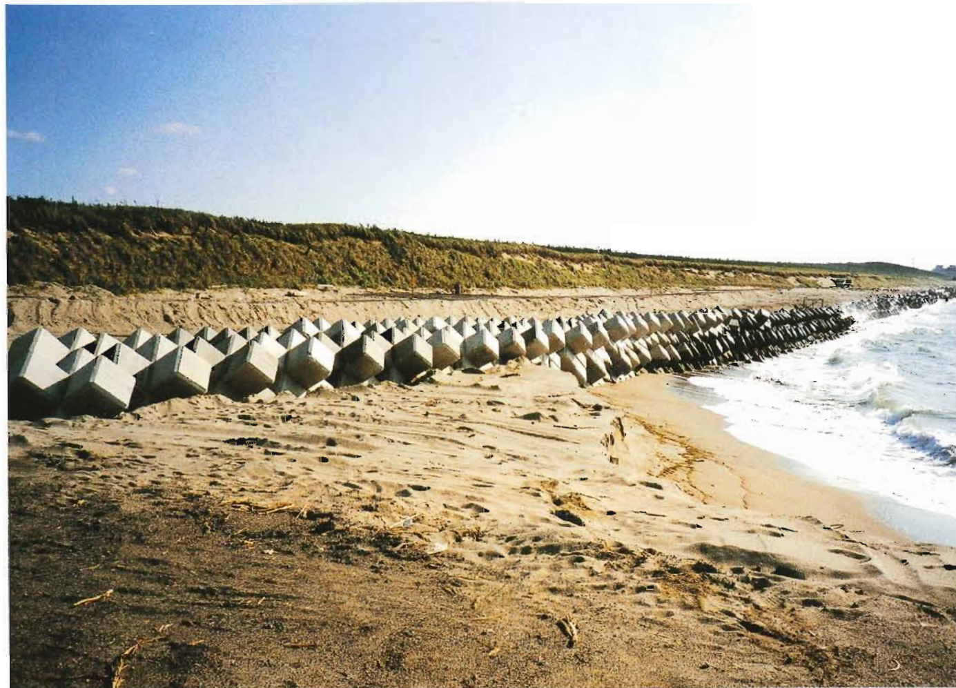
白木浜コンクリートブロック消波堤／波による海岸浸食が激しい箇所には、コンクリートブロック消波堤等により砂丘の侵食防止を図っている。
