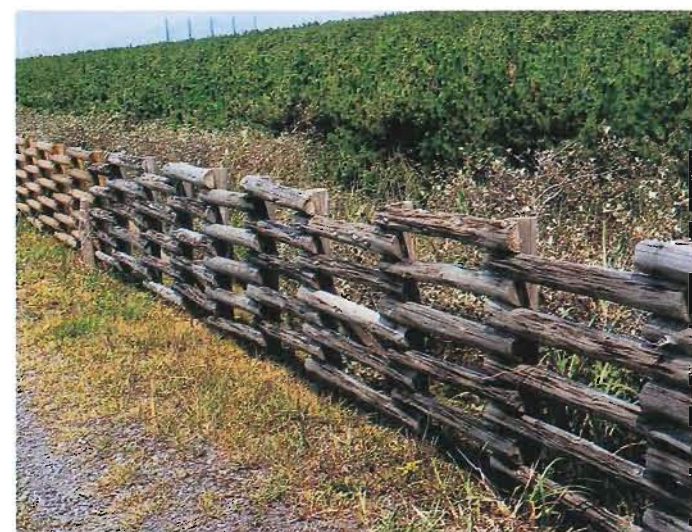
潮風により腐朽した丸太防風柵／10年をすぎると腐朽が著しい
